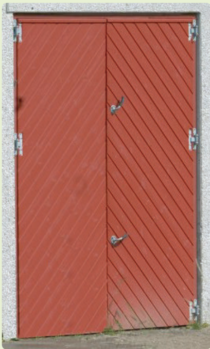
▲ RU-port med trepanel.
